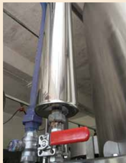
Les tuyauteries sont isolées et gainées d'inox.
